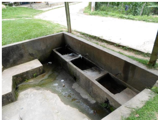
Foto 6: Bicas d'água (três) que dão vazão às águas do reservatório de água da nascente. – 22/11/16
