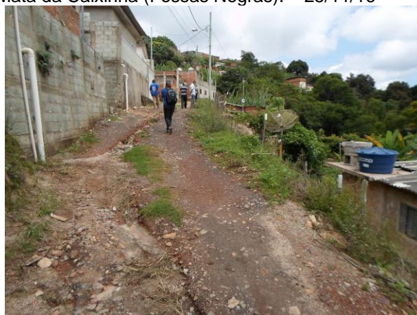
Foto 18: Via à montante da Mata da Caixinha em trecho desprovido de pavimento e dispositivos de drenagem. – 25/11/16
