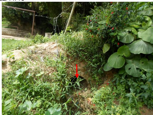
Foto 4: Manilha da drenagem pluvial proveniente da Mata da Caixinha, com descarte em uma grota onde foi relatada a ocorrência de nascente. – 25/11/16
