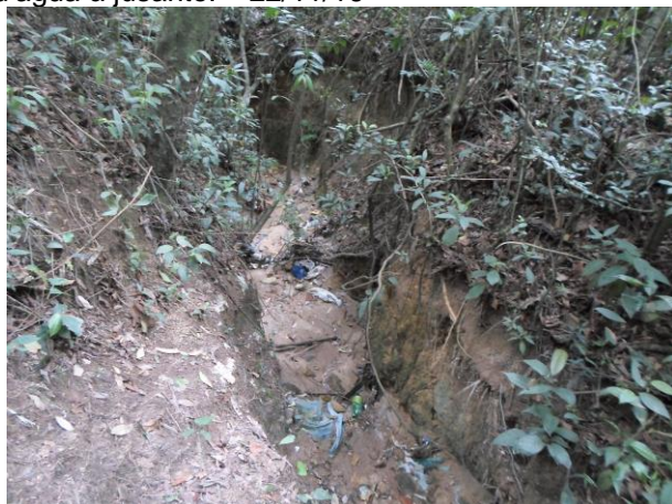
Foto 9: Canal de drenagem pluvial no interior da Mata da Caixinha, submetido a processos erosivos e disposição de resíduos sólidos. – 22/11/16
